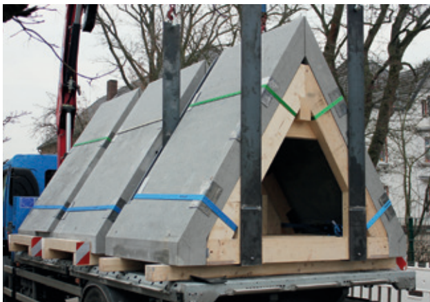
Mit einem Schwertransporter wurden die drei im Aachener Werk zusammengebauten Dachelemente zur Baustelle transportiert
